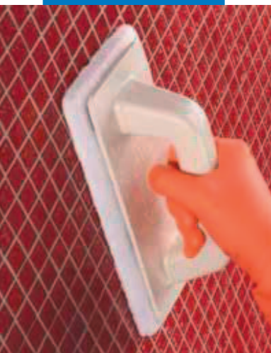
Curățarea finală a mozaicului din sticlă cu un pad Scotch Brite® umed
